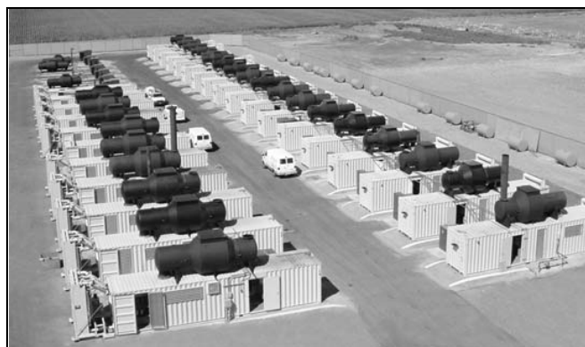
Дизельная генераторная станция мощностью 60 МВт, оснащенная двухтопливной системой GTI, восполняющая потребности энергии в период пикового потребления
